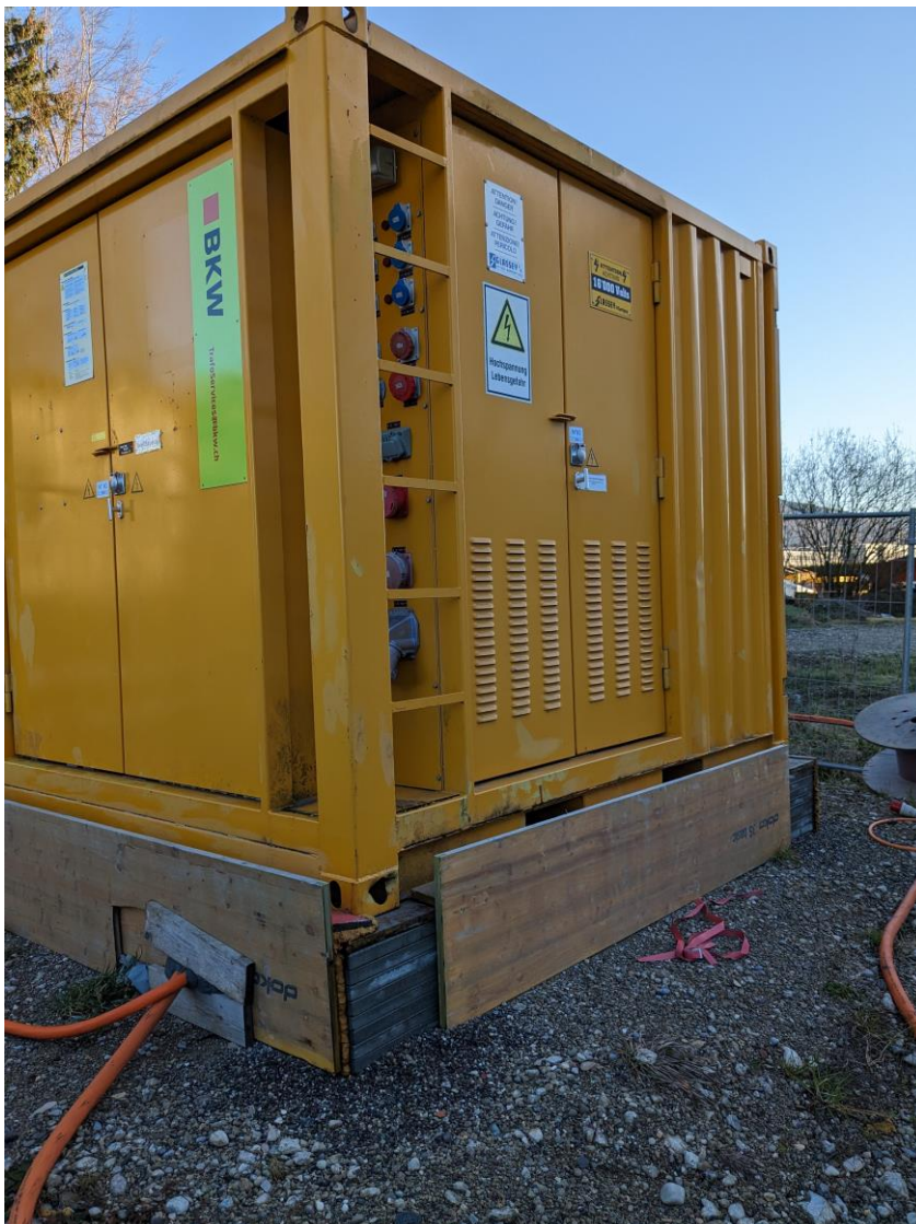
Temporäre Trafostation für Neubau Meier Tobler AG
