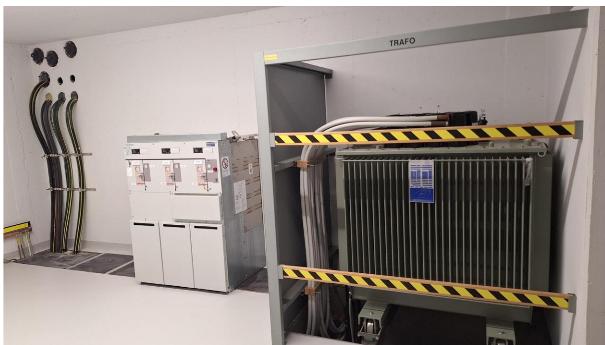
Sanierte Trafostation Steinmatt
