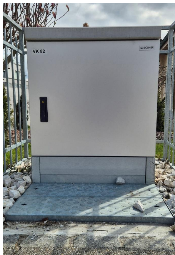
Neue Verteilkabine an der Hauptstrasse VK82
